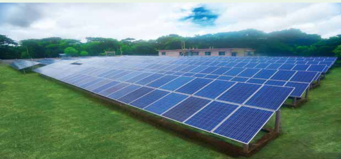
Solar Mini Grid
